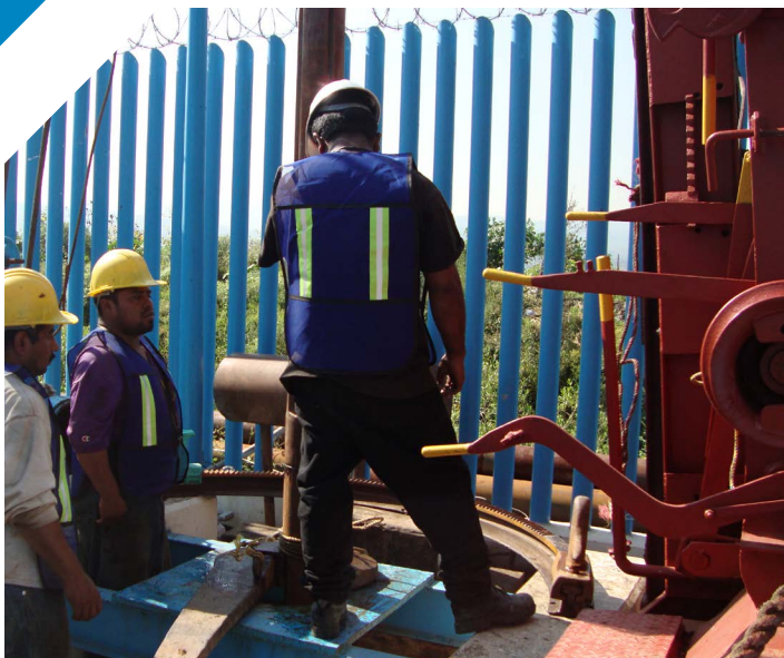
Equipo de bombeo
