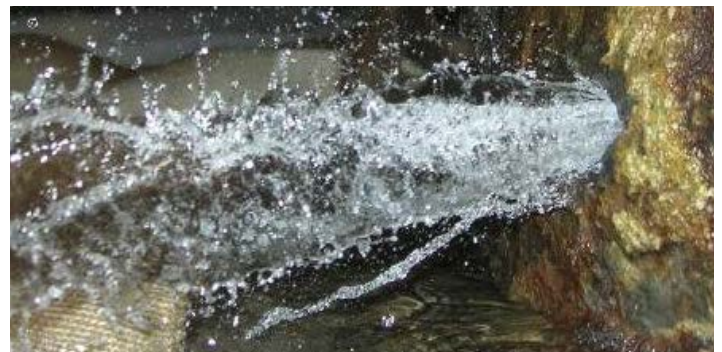
Tubería con corrosión de espiras
