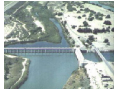
Afectación de puente por socavación en la margen del río
